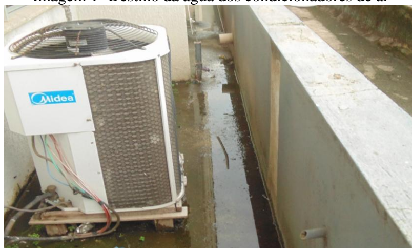
Imagem 1- Destino dá água dos condicionadores de ar
