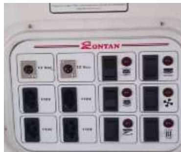
Figura 4 - Painel Elétrico Alimentação
