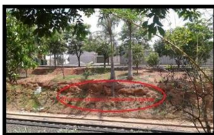
Figura 1 - Processos erosivos destacados no trecho em estudo
